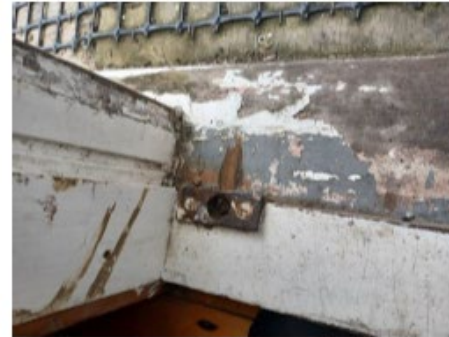
19. Malfunctioning bottom door keeper.
