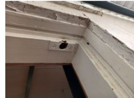
20. Malfunctioning top door keeper.
